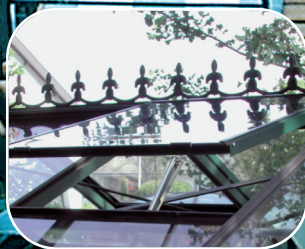
Dachfenster mit automatischen Fensteröffnern
